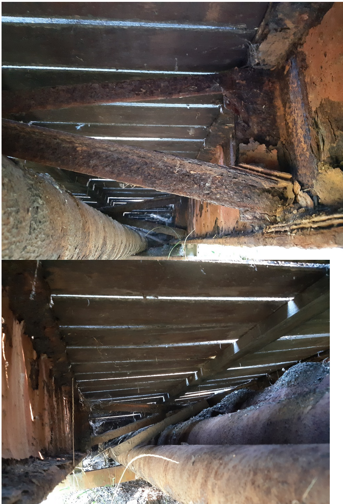
Fotografie současného stavu nosných a spojovacích kovových prvků, zkorodované potrubí jsou ocelové chráničky VN a NN el. vedení ČEZU
