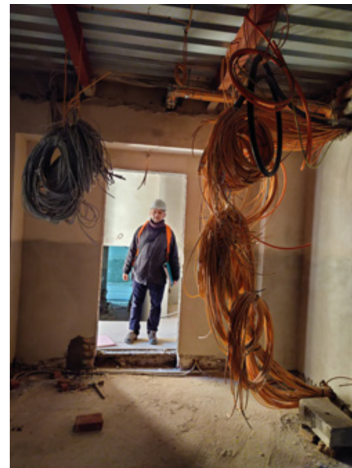
Kabeláž je na Záložně opravdu vydatná
