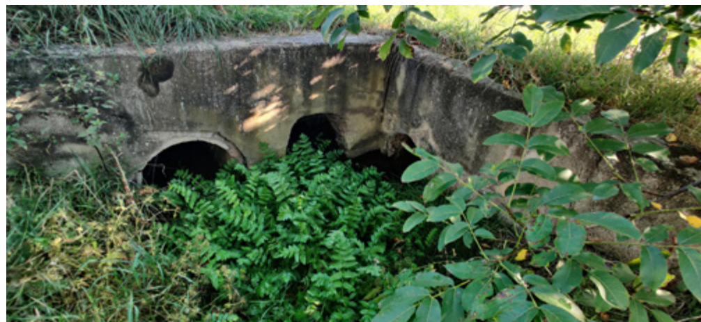
Celé povodí Svodnice je zavedeno do tohoto potrubí na rohu ulice Hradební a Nábřeží
