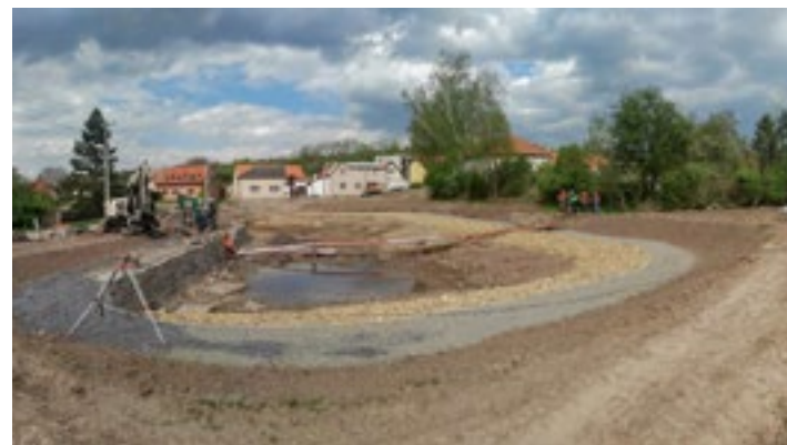
Nádrž na Velké Bučině se už vylupuje - foto P. Bakalář
