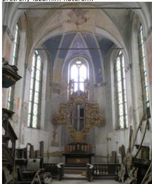
Interiér kostela na svou opravu teprve čeká...
