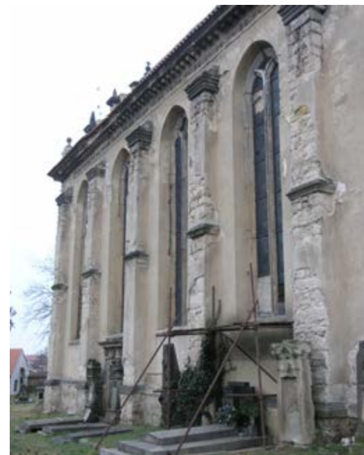
Jižní strana kostela před opravou...
