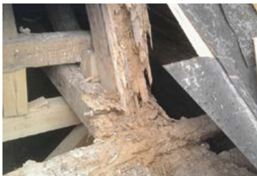
Stav krovu byl před několika lety neutěšený
