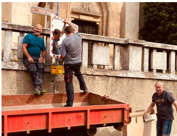
↑ Technická četa instaluje nové zrcadlo
